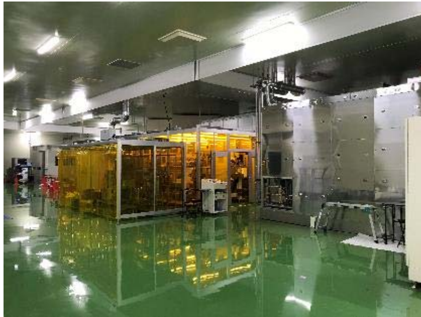
クリーンルームに搬入された設備
